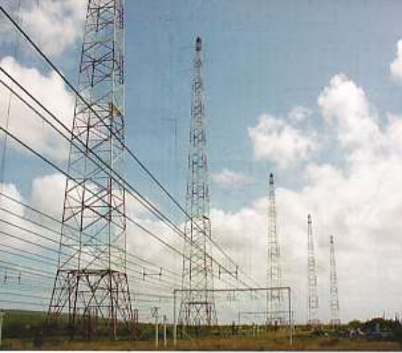
Deel antennepark op zendstation Wereldomroep in Bonaire
